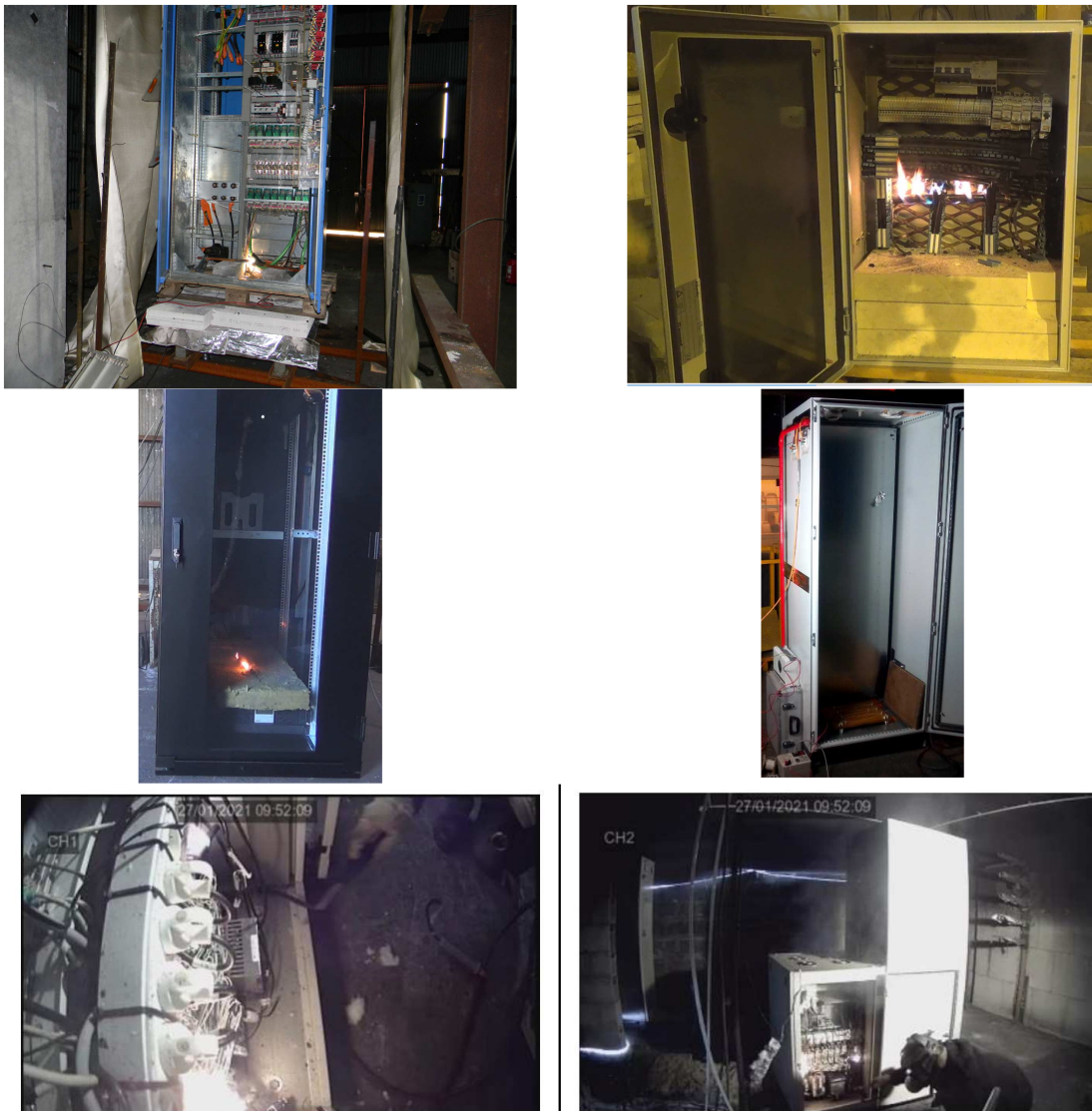
Figure 13 : Exemples d'essais sur des équipements électriques réalisés au CNPP
